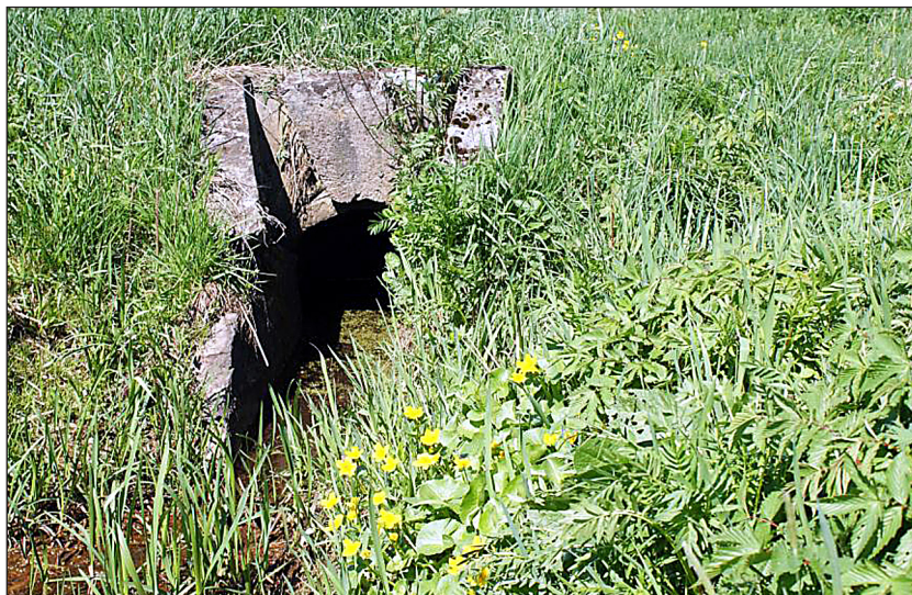
Fot. 2. Zniszczony i zamulony przepust na rowie melioracyjnym, fot. A. Kiryłuk Phot. 2. Destroyed and silted culvert on the meliorated ditch, phot. A. Kiryłuk
